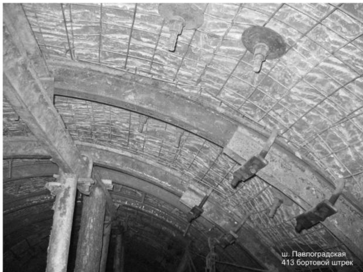
Рис. 4 – Состояние 413 бортового штрека в 30 м за линией очистного забоя
